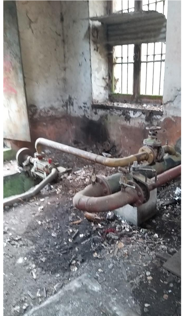
Les pompes de refoulement
