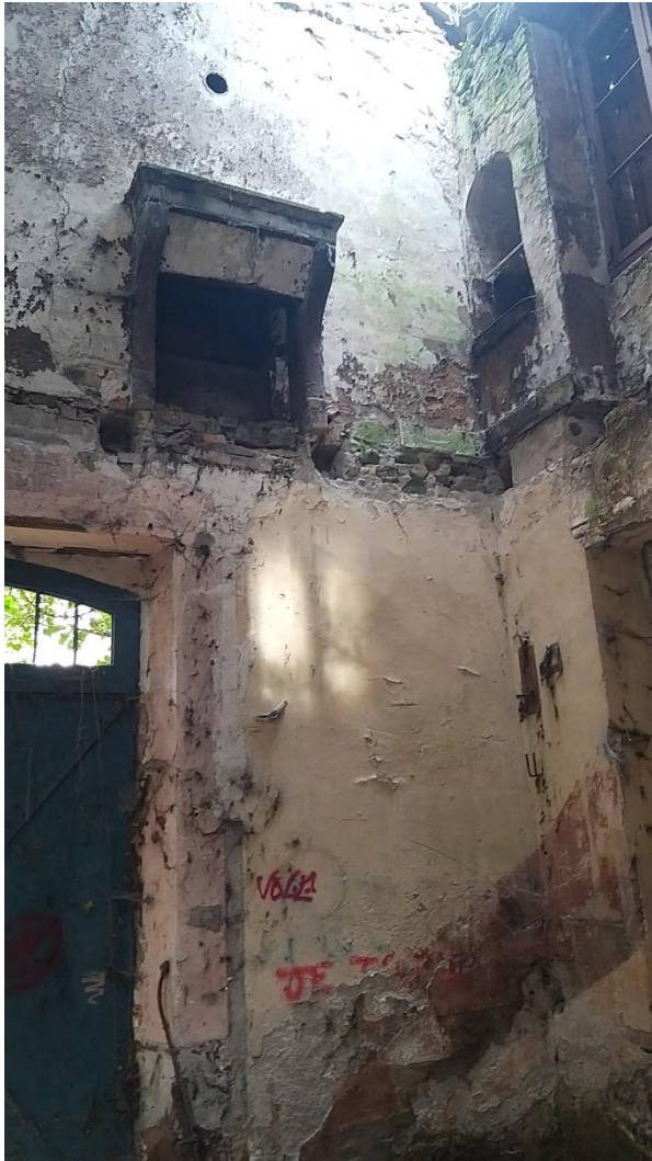
La cheminée suspendue à l'intérieur de Le station de pompage
